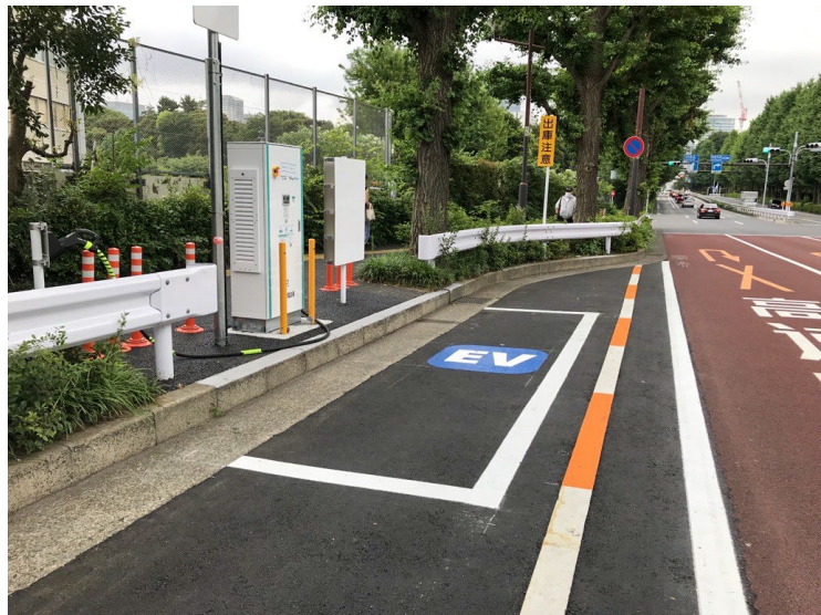
EV用急速充電ステーション全景（JR信濃町駅南口近傍）
