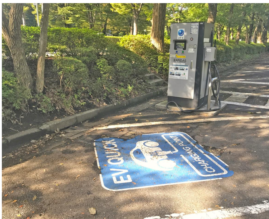
砧公園駐車場に設置されている急速充電器
